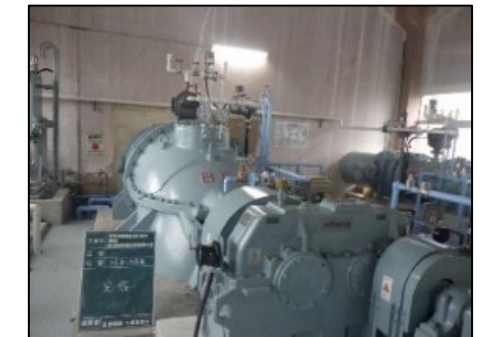
横軸軸流ポンプφ1200 (事業実施後)
