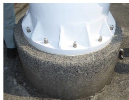
基礎部に海水が浸入しアンカーボルトの腐食により倒壊するおそれがある
