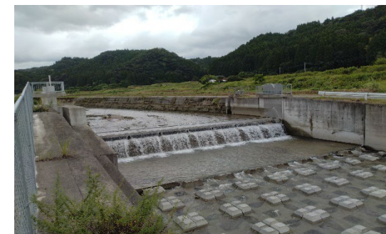
写真1 被災の無かった竹島頭首工(可動堰へ改修済)
