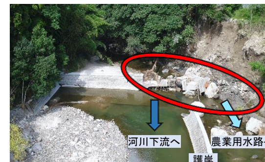
写真2 被災した原ノ丸頭首工(固定堰) 頭首工と護岸(左岸)が被災し、左岸側にあった農業用水路が流亡
