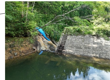
未改修ため池の被災状況
