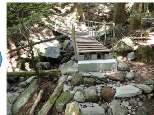
対策工実施後(R6)
