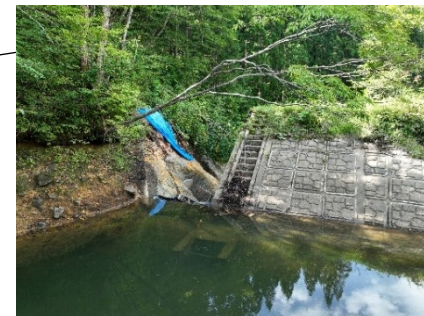
未改修ため池の被災状況
