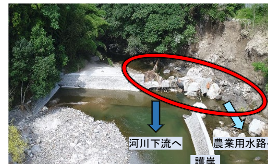
写真2 被災した原ノ丸頭首工(固定堰) 頭首工と護岸(左岸)が被災し、左岸側にあった農業用水路が流亡
