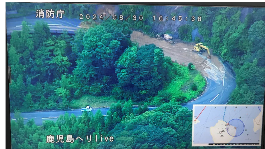
台風10号における被災地映像(鹿児島県屋久島)
