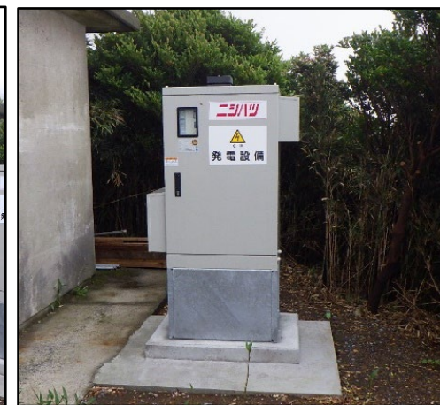
本対策で設置した 非常用発電機
