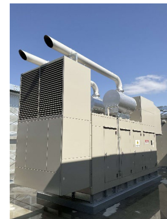
非常用自家発電設備(拡大)
