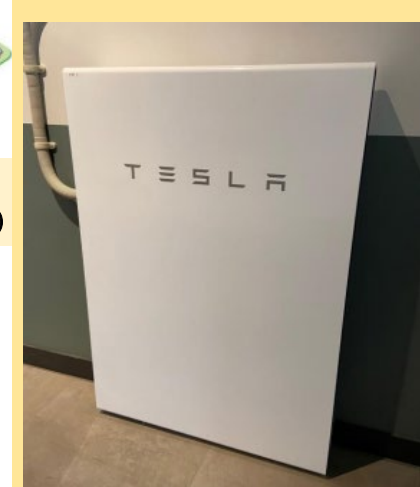
▲蓄電池本体(1台あたり) 容量13.5kWh、出力5kW
