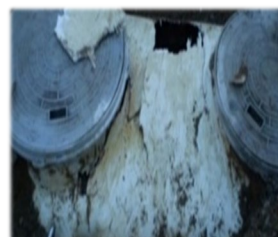
老朽化している単独処理浄化槽
