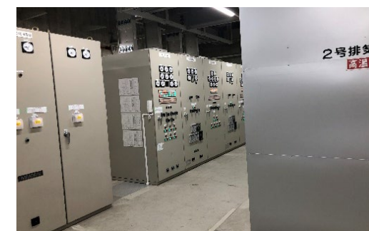
改修後 自家発電装置同期盤
