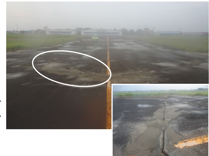
対策範囲外の液状化の様子（N2誘導路）
