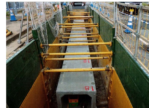
雨水管渠(整備中)
