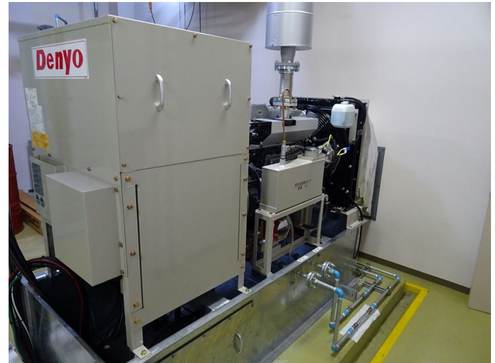
警察通信の維持のために更新した無線中継所の非常用電源設備
