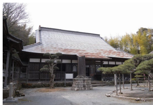
本堂外観(修理前)
