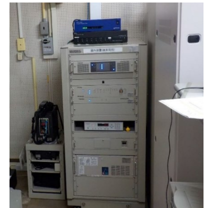
衛星通信装置(白石市庁舎)
