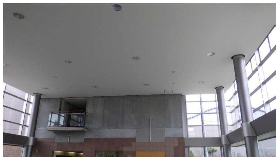
発災後の エントランスホール天井 (令和4年4月時点)
