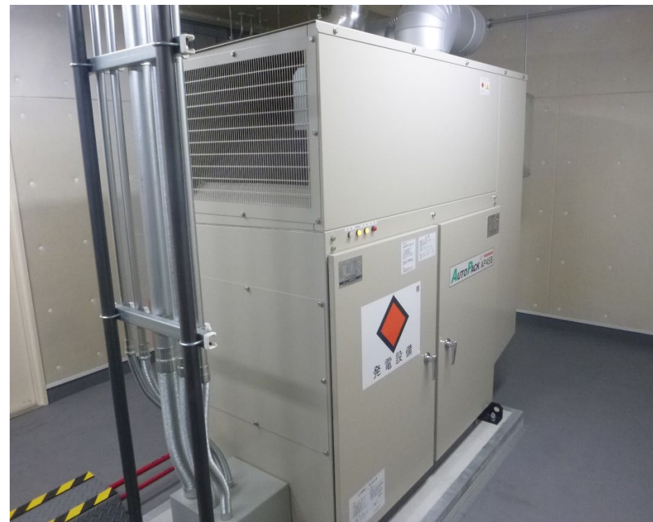
警察通信の維持のために更新した無線中継所の非常用電源設備
