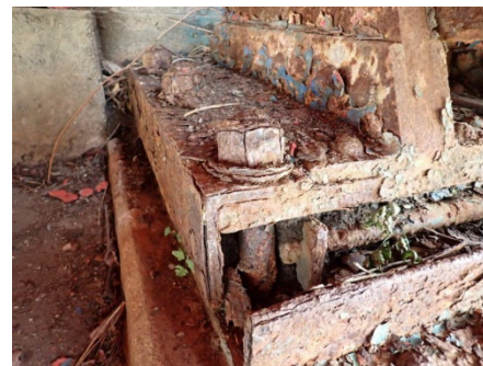
支承の腐食、アンカーボルトの欠損
