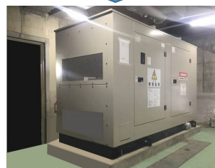
自家発電設備(改修後)
