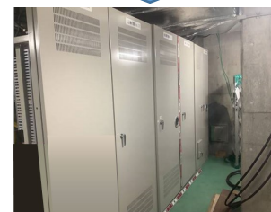
受変電設備(改修後)
