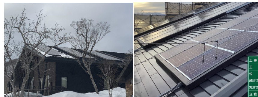
改修した太陽光発電設備
