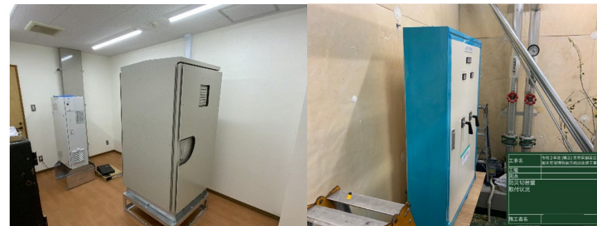
設置した蓄電池
