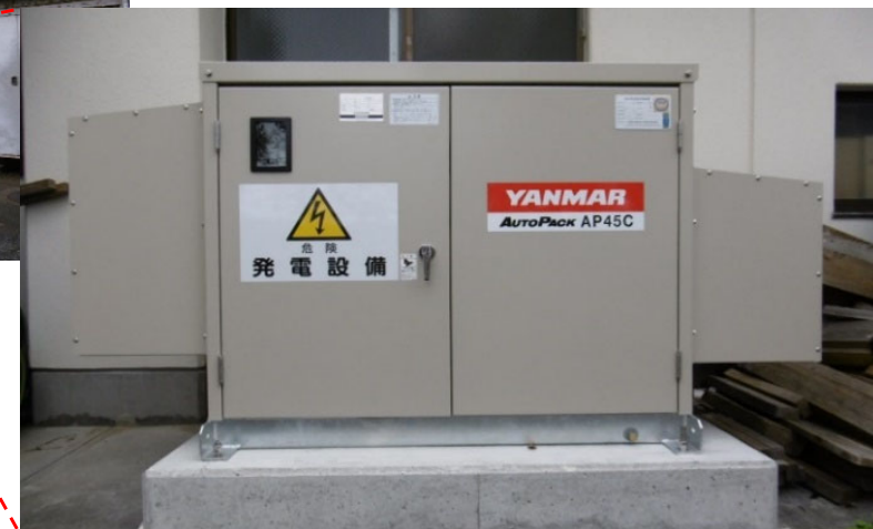
整備した非常用自家発電設備
