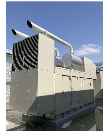
非常用自家発電設備(拡大)
