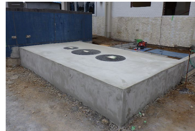
地下燃料タンク
