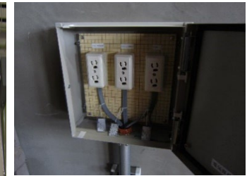
非常用コンセント
