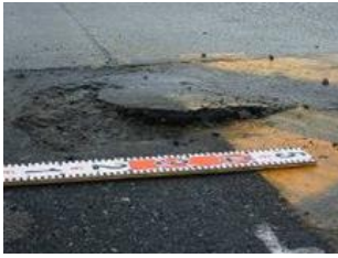
老朽化した舗装の剥離
