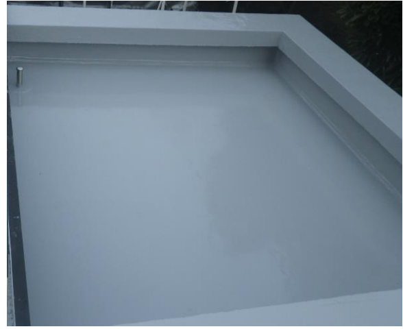
浴室棟屋上（施工後） 既存防水層を覆うようにウレタン塗膜防水を施工し、新たな防水層を形成した。
