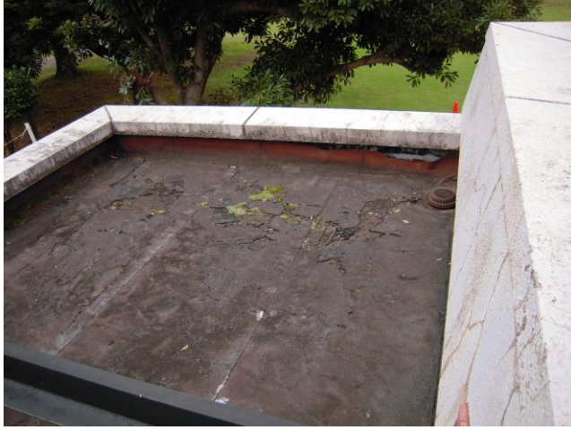
浴室棟屋上（施工前） 既存防水層の著しい劣化（亀裂・はがれ）が見られる。
