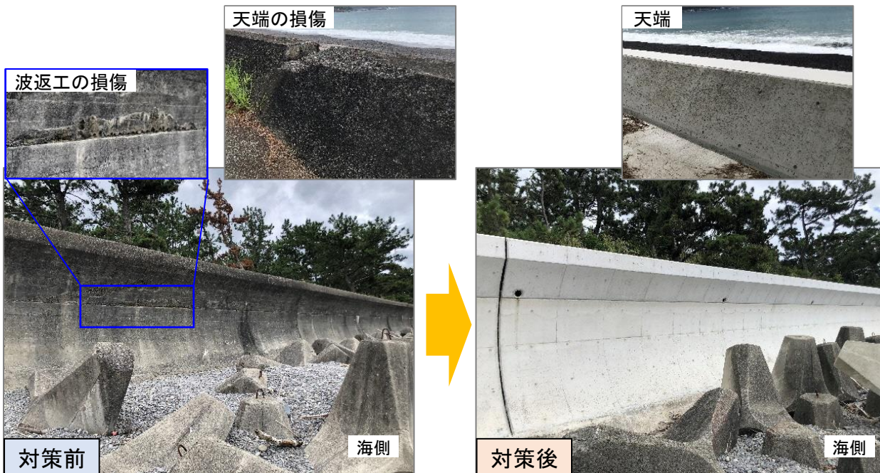
対策前：波返工の損傷 (コンクリート打ち継ぎ目が剥離し、脆弱になっている)
