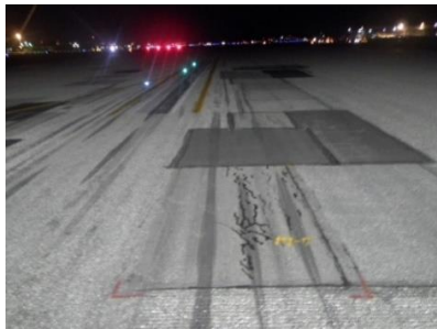
老朽化した滑走路舗装
