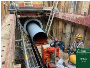
既設管の中に耐震性のある鋼管を挿入するPIP（パイプインパイプ）工法の実施
