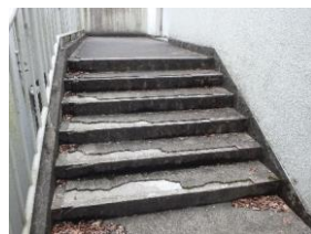
避難導線となる屋外階段の劣化
