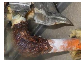
配管の腐食による漏水の発生
