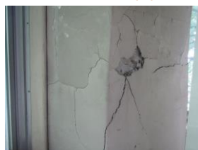
鉄筋の腐食によるクラックの発生
