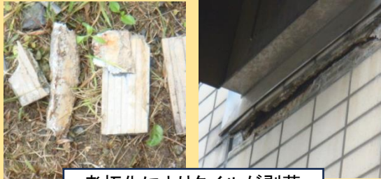
老朽化によりタイルが剥落
