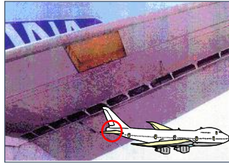
・エンジンテスト中に舗装が剥離 ・航空機本体及び尾翼が破損
