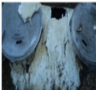
老朽化している単独処理浄化槽
