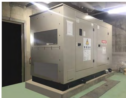
自家発電設備 改修後
