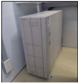
無停電電源装置 (今回更新)
