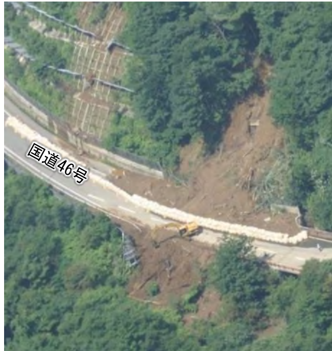
平成25年8月豪雨による被災（法面崩壊）
