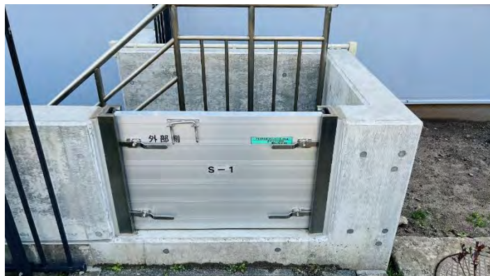
止水板設置：地下階に設置している受変電設備、自家発電設備の洪水による浸水を防ぐため設置
