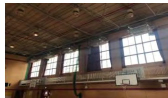
避難所の空調設備
