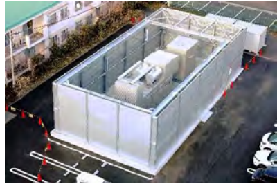
非常用自家発電設備（全景）
