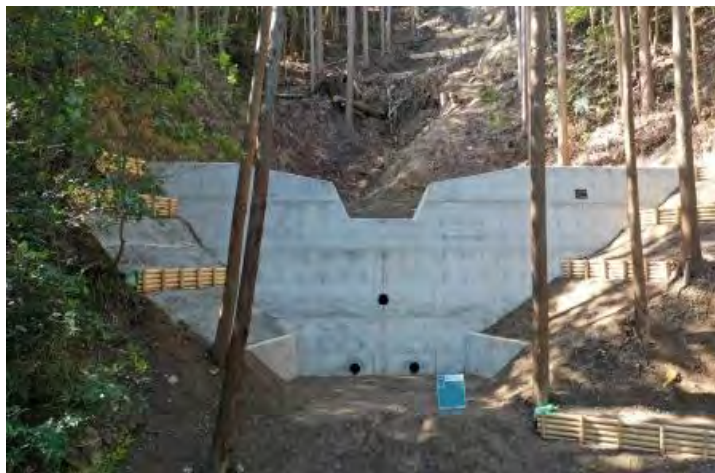
土石流等が発生するおそれがあるため、治山ダムを設置 (静岡県浜松市天竜区)
