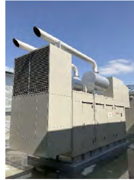
非常用自家発電設備（拡大）
