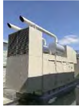
非常用自家発電設備（拡大）
