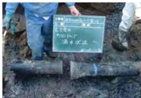
東日本大震災被害状況
