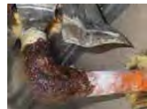
配管の腐食による漏水の発生
