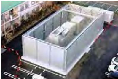
非常用自家発電設備（全景）
