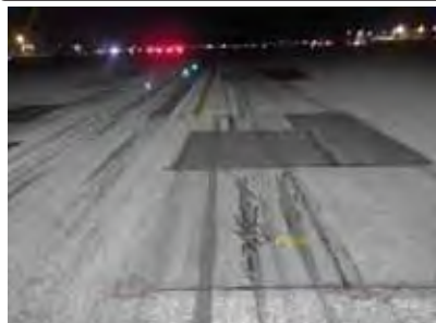
老朽化した滑走路舗装
