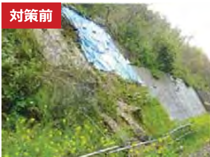
落石発生(令和2年3月)
