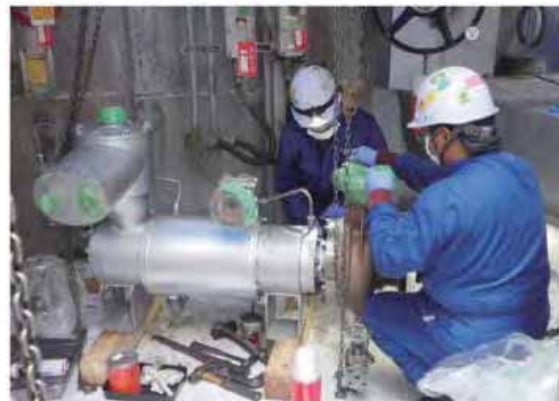
補修等の写真
