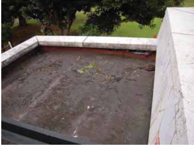
浴室棟屋上（施工前） 既存防水層の著しい劣化（亀裂・はがれ）が見られる。
