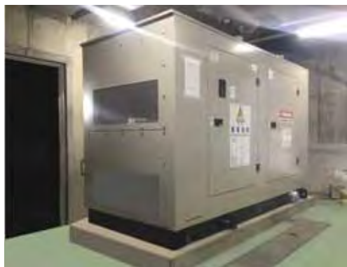
自家発電設備 改修後
