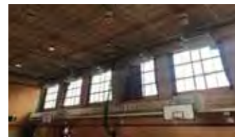
避難所の空調設備
