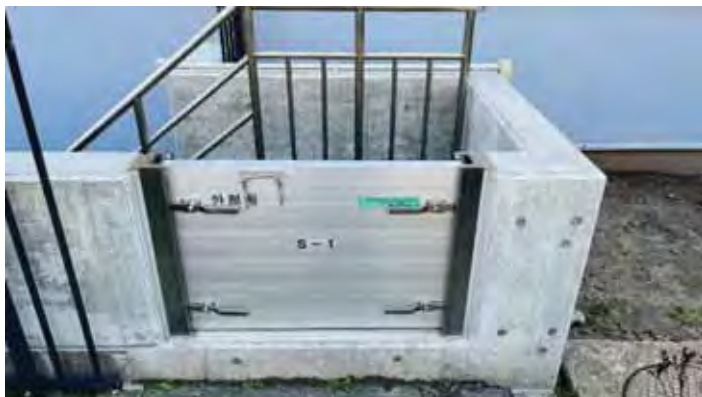
止水板設置：地下階に設置している受変電設備、自家発電設備の洪水による浸水を防ぐため設置
