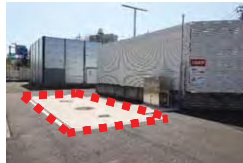
非常用自家発電設備用 埋設型燃料タンク②
