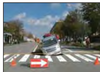
道路陥没による通行止め
