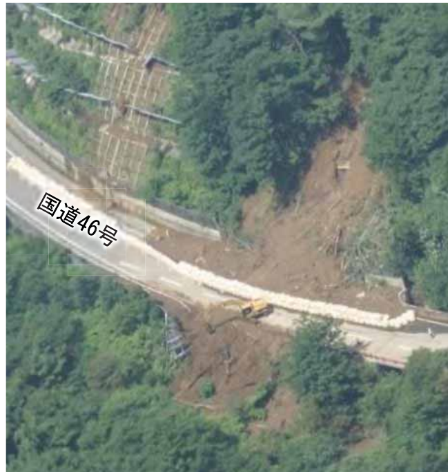
平成25年8月豪雨による被災（法面崩壊）
