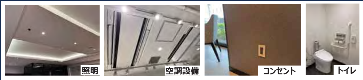
災害時に活用可能な設備（一例）
