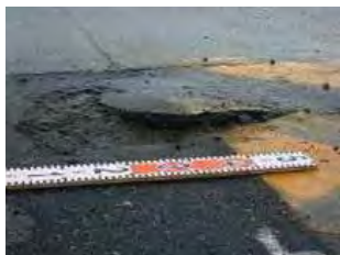
老朽化した舗装の剥離
