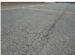
老朽化した基本施設舗装
