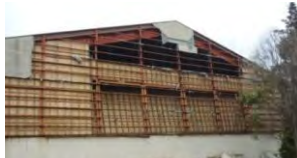
外壁の全面的な脱落
