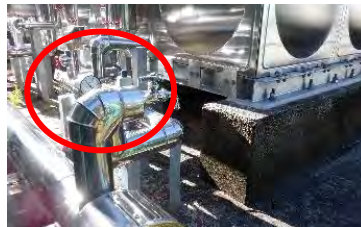
非常用蛇口を設け、地震等の災害時に受水槽から直接供給
