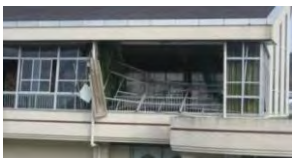
横連窓の障子ごとの脱落
