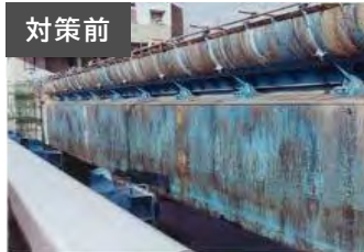
対策前 腐食が進行した堰ゲート
