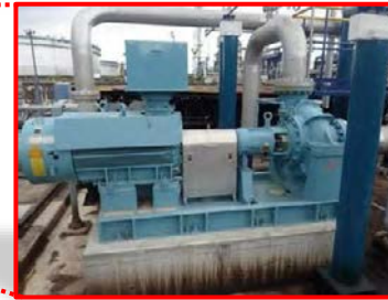
排水ポンプの増強
