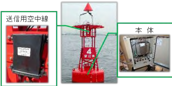
クラウド監視装置を航路標識に設置し、航路標識の異常(消灯、移動、流出等)を把握
