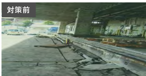
地震による施設被害
