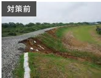
対策前 雨水により侵食した堤防法面
