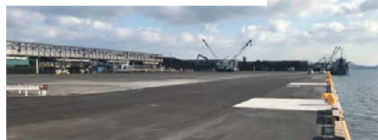
エプロンのクラック、沈下回復状況
