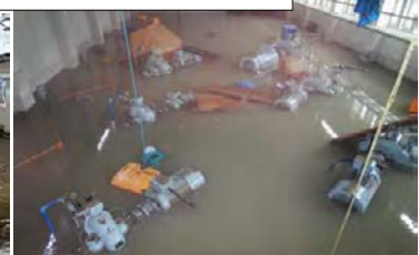
浄水場の浸水被害状況
