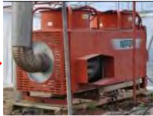
保温設備(暖房機)
