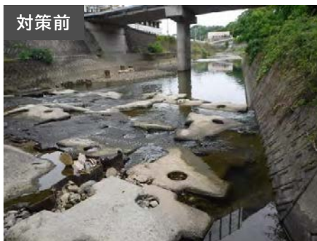
対策前 護床ブロック散乱・流出
