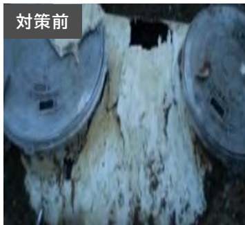
老朽化した単独処理浄化槽
