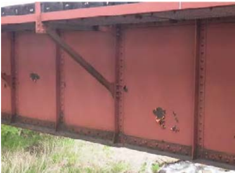
橋梁の老朽化が進行
