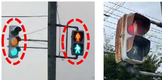
灯火異常(同時点灯)
