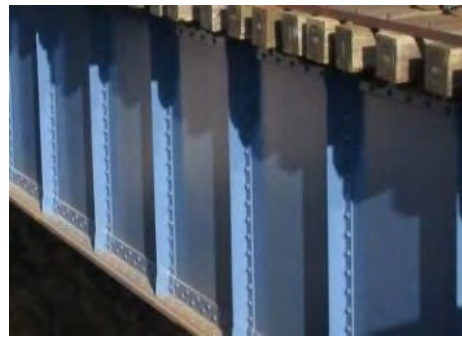
高耐久性・重防食塗料の塗装により長寿命化や維持管理コストの低減が期待される
