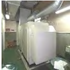
非常用発電機
