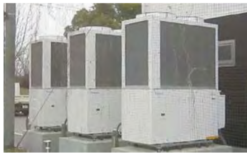
ガスエンジンヒートポンプエアコン(GHP)
