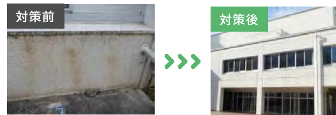
漏水の防止・壁剥落の防止
