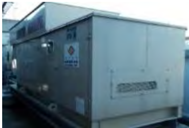
非常用自家発電設備の整備等により、地震による停電時でも電力喪失を回避し、診療機能を維持
