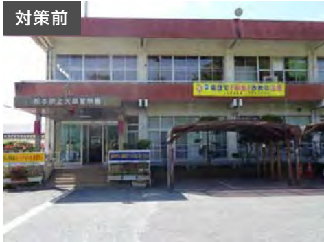
対策前 建築後50年以上経過した老朽化した警察署であり、耐震性も不十分な状況
