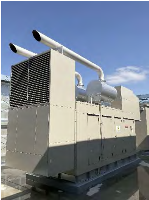
埋設型燃料タンクの整備と併せて整備を行った非常用自家発電設備
