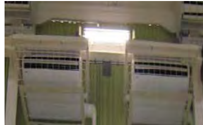
エアコン(室内機)
