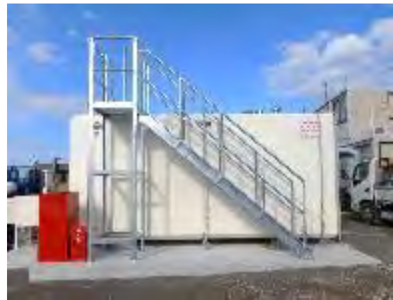
災害時における燃料供給体制確保のため、耐災害性を強化した給油設備の整備を実施
