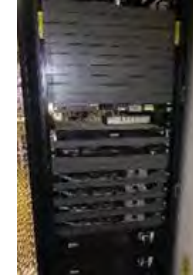
電力監視設備
