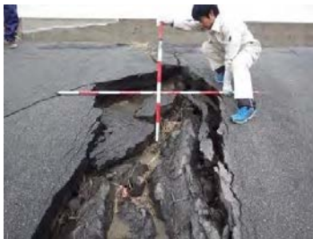
堤防法面の陥没
