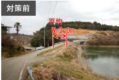
断面不足の堤体(W=2.0m,h=5.7m)
