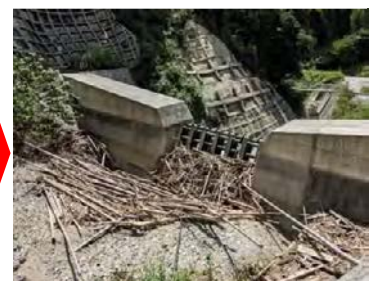
土石流発生後(R7.8)
