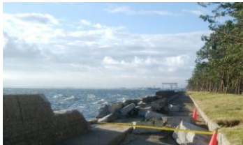
越波による護岸の倒壊
