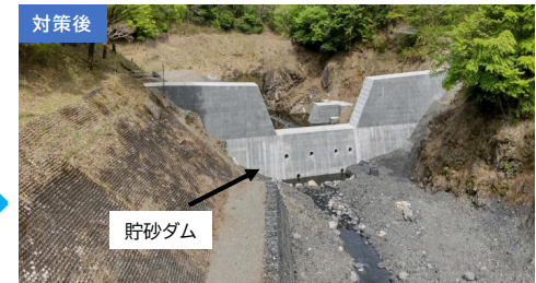
貯砂ダムの設置により堆砂を防止し、ダムの洪水調節機能の維持が可能に
