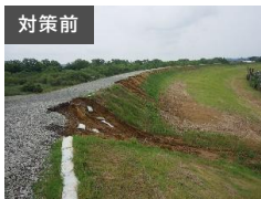
雨水により侵食した堤防法面
