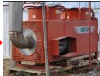
保温設備(暖房機)
