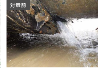
前回災害による漏水事故 (平成30年度 胆振東部地震)
