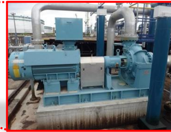
排水ポンプの増強
