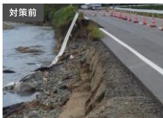
豪雨により隣接する河川が増水し、道路の一部が流出
