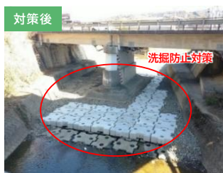
護床ブロックによる洗掘対策
