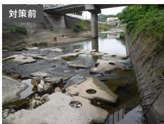
護床ブロック散乱・流出
