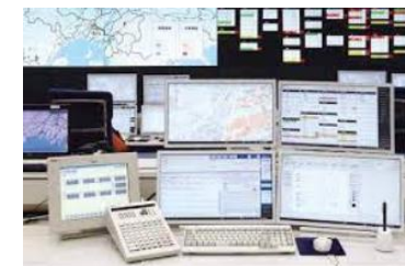
消防指令システム 指令台の構成 写真:岡崎幸田消防指令センター
