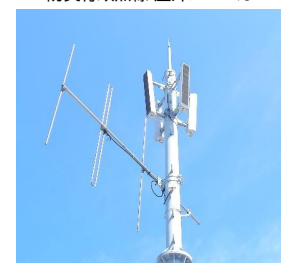
<防災行政無線 屋外スピーカー>
