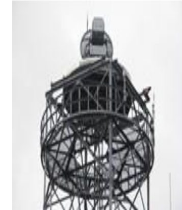
災害時において現場状況を把握するための設備
