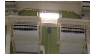
エアコン(室内機)
