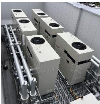
天然ガスコージェネレーションシステム
