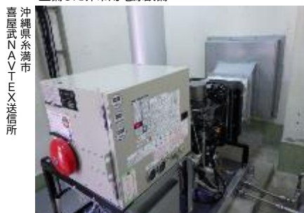
災害に伴う停電発生時においても、非常用電源設備からの給電により、通信体制を確保
