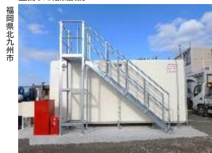
災害時における燃料供給体制確保のため、耐災害性を強化した給油設備の整備を実施
