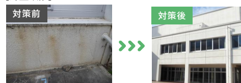
漏水の防止・壁剥落の防止
