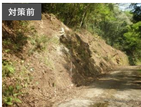
のり面が不安定な林道
