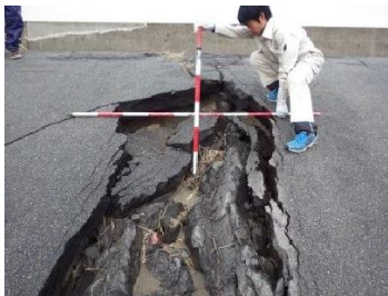
堤防法面の陥没
