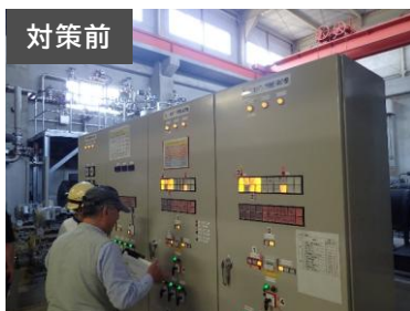
対策前 操作員による機側操作
