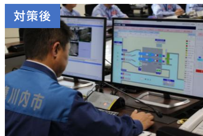
対策後 自治体(操作委託先)等からの遠隔操作
