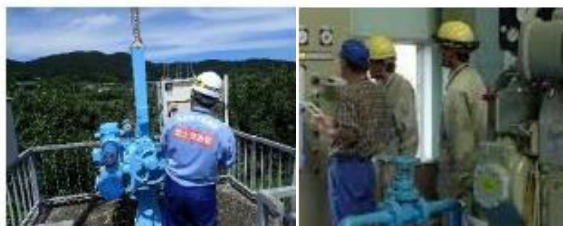
施設ごとに機械操作盤により操作
