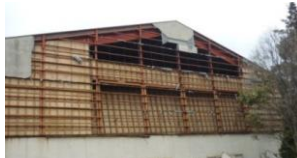
外壁の全面的な脱落
