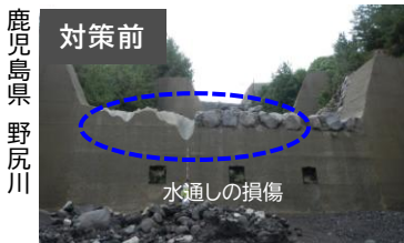
鹿兒島県 野尻川 1号堰堤 水通しの損傷
