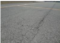
老朽化した基本施設舗装
