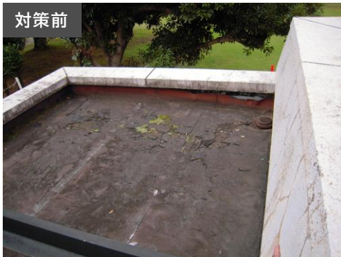
既存防水層の著しい劣化(亀裂・はがれ)が見られる
