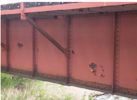
橋梁の老朽化が進行
