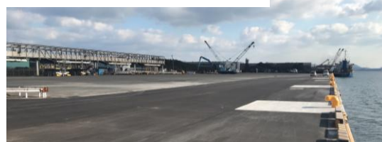
エプロンのクラック、沈下回復状況
