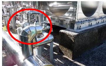
非常用蛇口を設け、地震等の災害時に受水槽から直接供給
