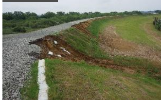
雨水により侵食した堤防法面
