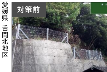
愛媛県 舌間北地区 整備から約30年が経過し、対策施設の老朽化が進行
