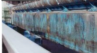
腐食が進行した堰ゲート
