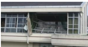
横連窓の障子ごとの脱落
