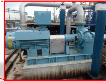
排水ポンプの増強
