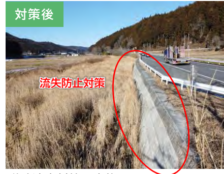
道路流出対策を実施
