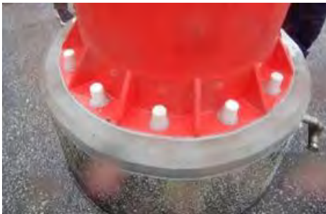
航路標識の基礎部等への海水浸入を遮断し、劣化・腐食を防ぎ、倒壊を防止
