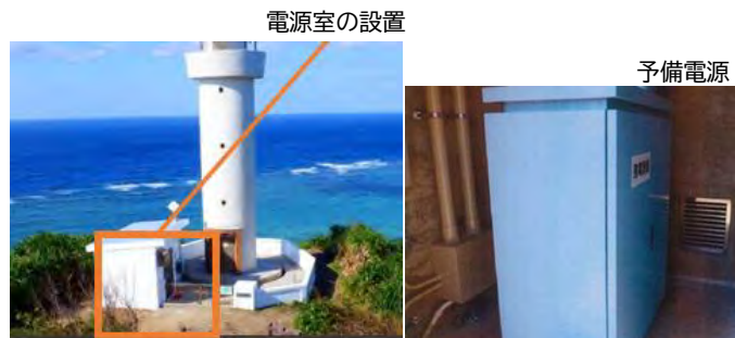
予備電源の整備又は主電源の太陽電池装置化により、停電時の灯台の消灯を防止
