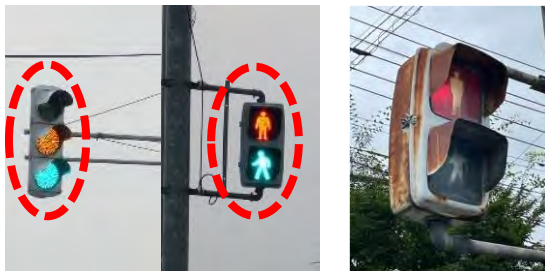
灯火異常(同時点灯)
