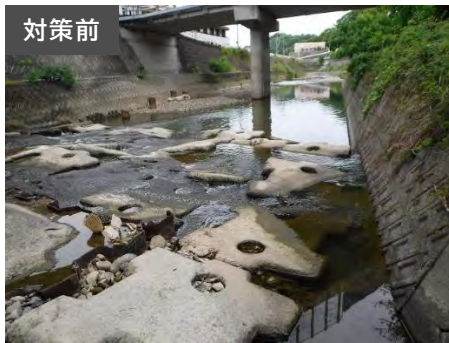
護床ブロック散乱・流出
