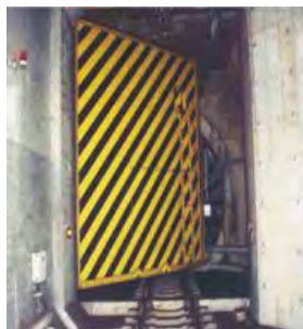
防水扉(トンネル内)
