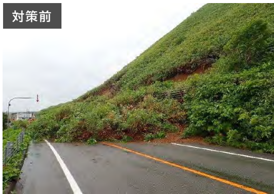
令和2年8月の豪雨で被災し、約2日間の通行止めが発生
