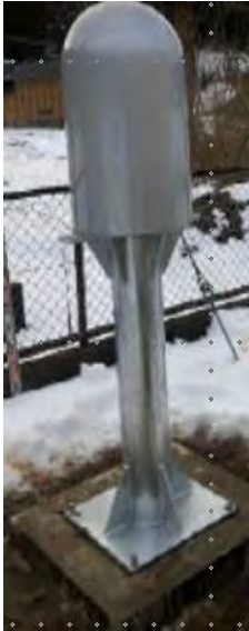
老朽化したモニタリングポストを最新機へ更新
