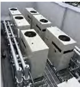
天然ガスコージェネレーションシステム
