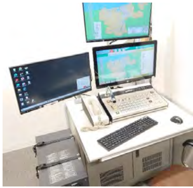
<防災行政無線 操作卓>
