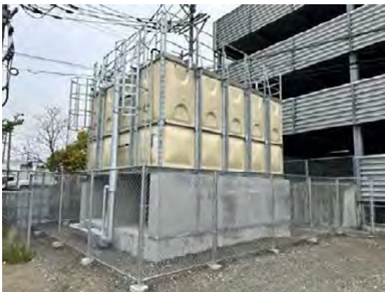
給水設備の整備等により、地震による断水時でも3日程度の診療機能を維持
