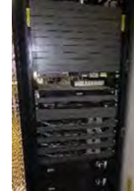
電力監視設備
