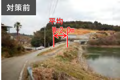
断面不足の堤体(W=2.0m,h=5.7m)
