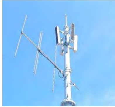
<防災行政無線 屋外スピーカー>
