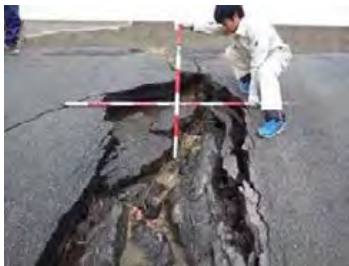
堤防法面の陥没
