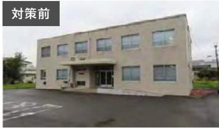
対策前 屋上の劣化(防水性に不備)
