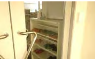
サーバ室のセキュリティ確保
