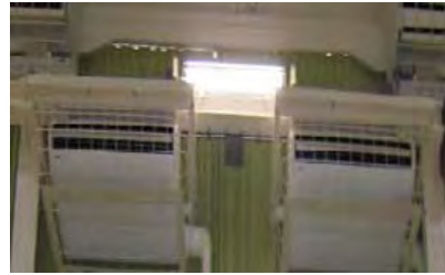
エアコン(室内機)
