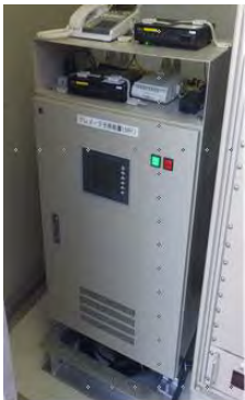
地震等による被害を防ぐため床面への固定等の実施
