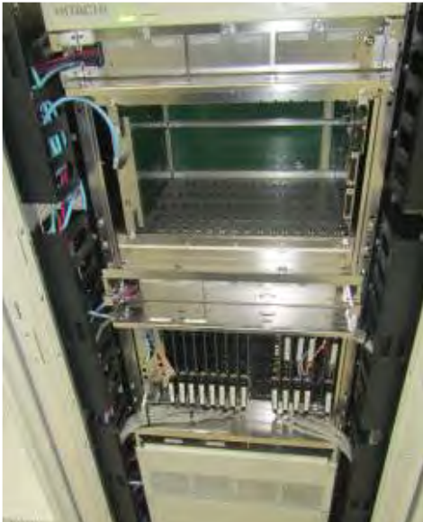
災害対策に必要な連絡手段を迅速かつ的確に確保するための設備
