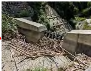
土石流発生後(R7.8)
