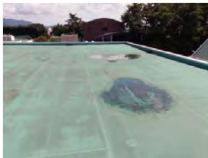
屋上部の改修による雨水浸入の構造体への影響の防止
