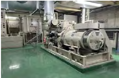
災害発生時に地下街利用者の安全を確保・退避施設として活用するため、非常用発電機の機能を強化
