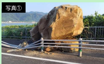
写真① 国道220号の落石 (R6.8地震(宮浦地区))
