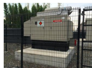
▲同ミュージアムの非常用長時間型防災用発電機化器機
