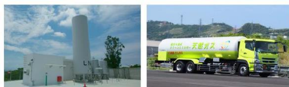
▲LNG サテライト設備と輸送するタンクローリー
