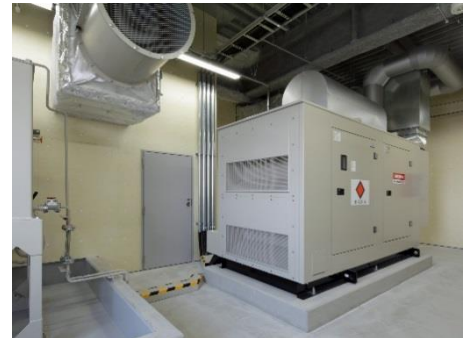
▲非常用発電機
